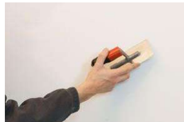
Les légères bavures de la finition murale à la chaux 0,5 mm sont grattées à l'aide de la truelle.
